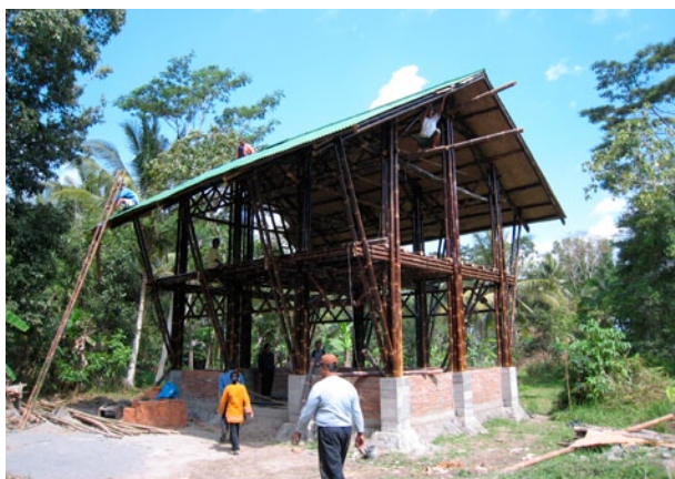
写真3 竹を建築資材として用いた建築中の2階建て家屋。土木工学部のムナワール教授のグループの研究成果。
